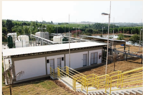
ETEA. Resultado foi a redução em até 70% da captação de água do subsolo
