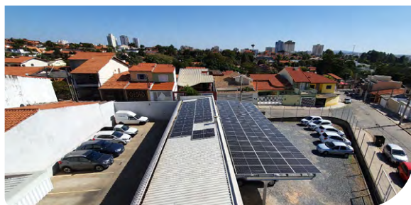
Sistema Carport implantado na MultMed
